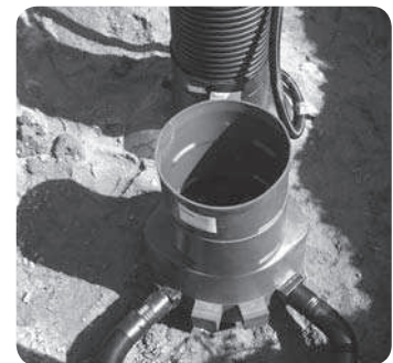
Från fosforfällan leds vattnet till fördelningsbrunnen, varifrån det distribueras till mark/infiltrationsbädden.
